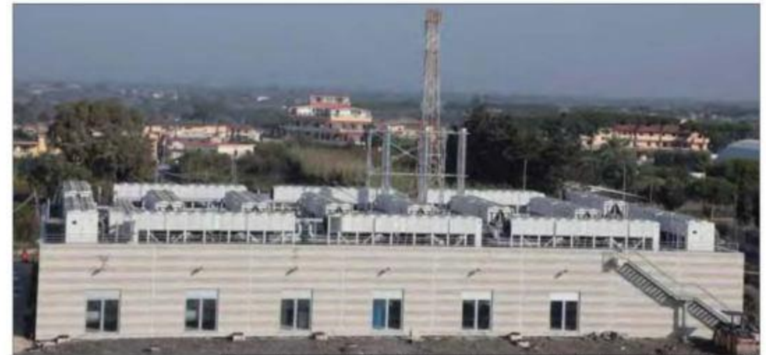
Centrale tecnologica (Veduta d'assieme) - Technological Plant (View)
