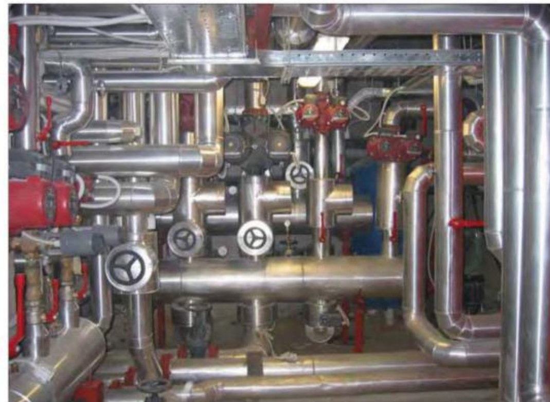
Sottocentrale termofrigorifera zona "cementi" - Special Plant
