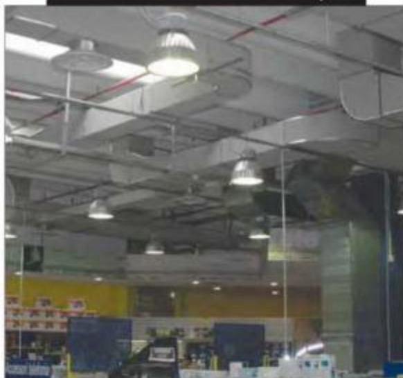
Distribuzioni aerauliche - Aeraulic System
